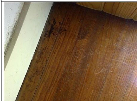
Photo n° PhTer009 Localisation : Etage 1 - Chambre 1 Ouvrage : Sol - parquet Parasite : Insectes à larves xylophages Indices : orifices obturés ou non (présence sur tout l'élément concerné) Localisation sur croquis : 009
