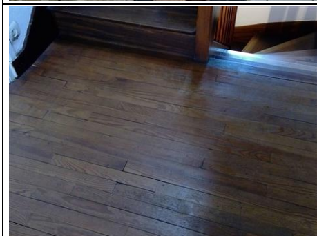
Photo n° PhTer008 Localisation : Etage 1 - Palier 1 Ouvrage : Sol - parquet Parasite : Insectes à larves xylophages Indices : orifices obturés ou non (présence sur tout l'élément concerné) Localisation sur croquis : 008
